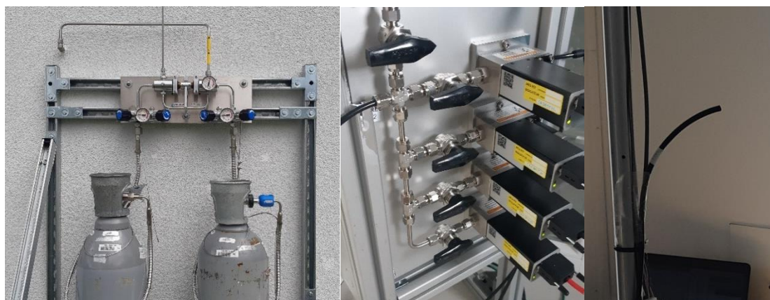
Figure 2.10 : Bouteilles de CO 2 , vannes et débitmètre d'injection, et extrémité du tuyau d'injection.
